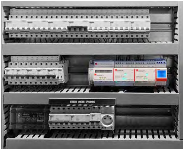
Die Systemgeräte wie Router, Netzteile usw. wurden im Schaltschrank neu verbaut.
